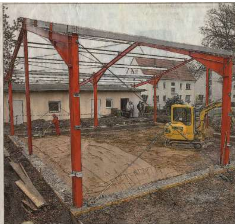
Die Erdarbeiten für die Bodenplatte aus Beton für den neuen Übungsraum des MTV Schöningen auf der vereinseigenen Sportanlage laufen. Foto: Bauer
